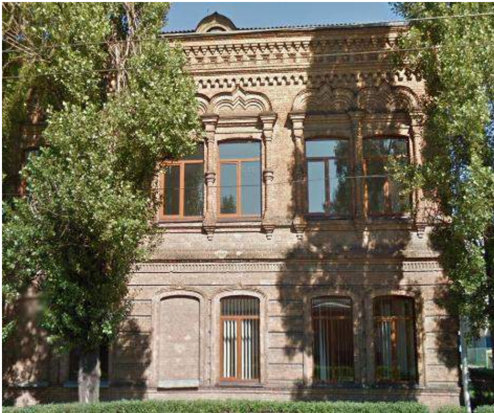
Неавтентичне «сліпе» вікно на одному з фасадів будівлі колишньої жіночої гімназії.
