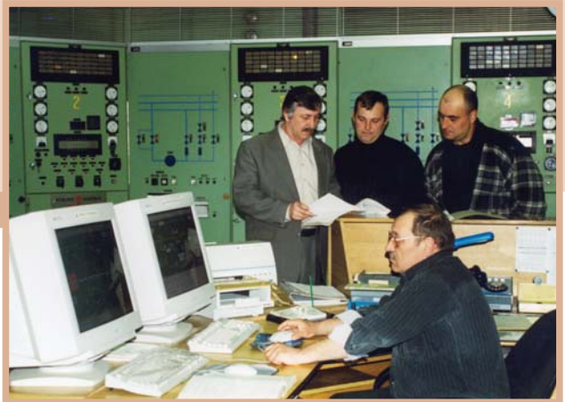
На газокompресорній станції
